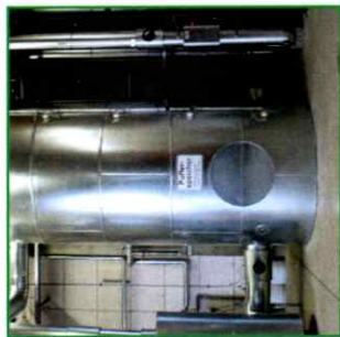
Warmwasserpufferspeicher: 15.000 Liter Fassungsvermögen
